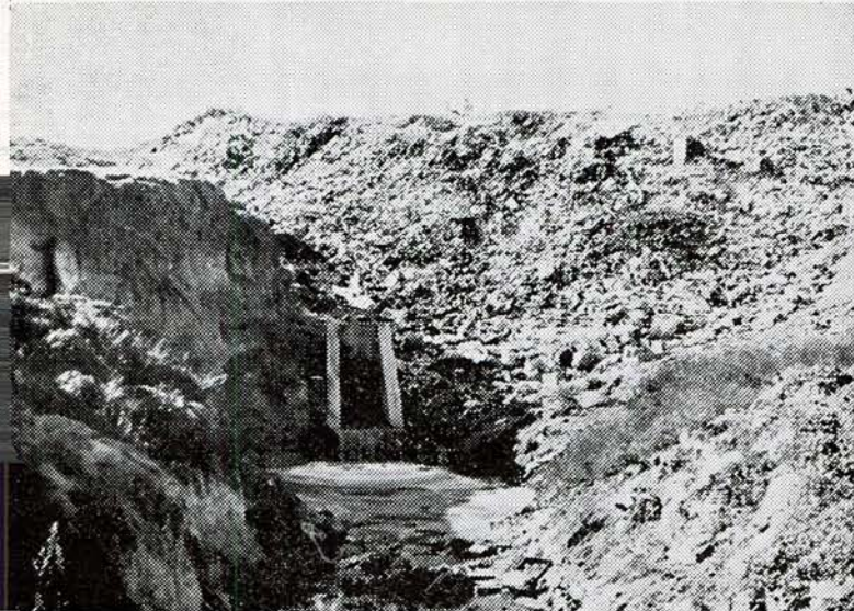
Vertedero sobre la salida de un colector
