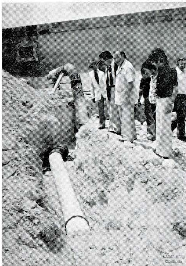
En Puente Genil, D. Diego Romero, visitó las obras de conducción de aguas a la Estación Depuradora, cuando estaban próximas a concluir
