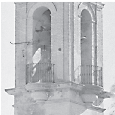
Detalle de los balcones convexos con rejería de protección, que se ubican en el cuerpo de campanas.
