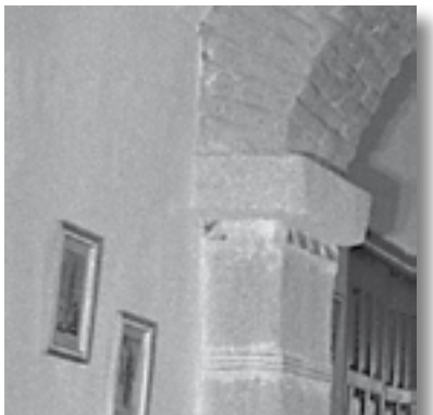
Detalle de uno de los arcos de ladrillo sostenido por una imposta volada de granito.
